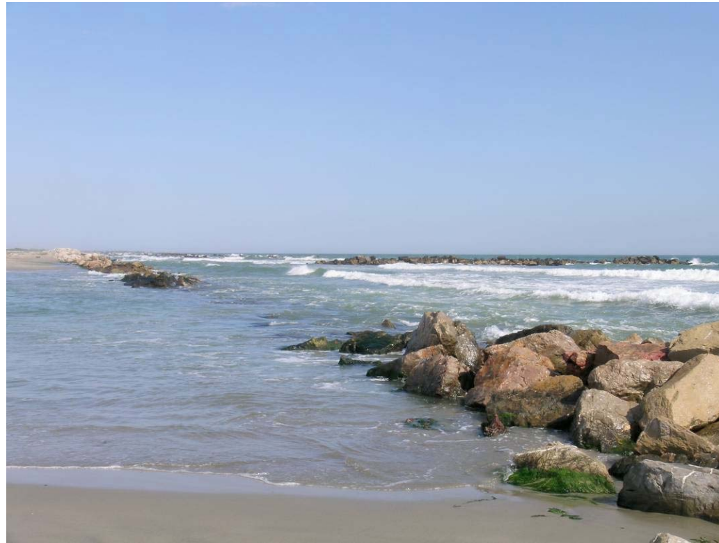
Digue frontale du Grand Radeau (brèche et épis déracinés) PNRC, 25.04.06
